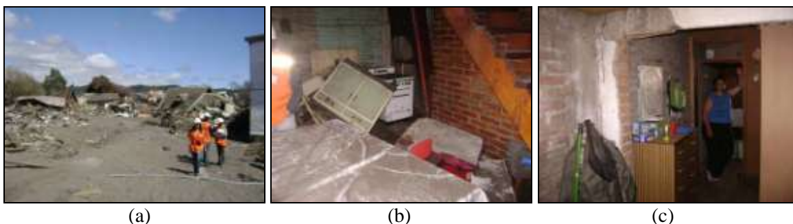
Figura 3. (a) Escombros arrastrados por tsunami, (b) Viviendas de dos pisos sólo con daños no estructurales (c) Modificaciones no controladas de la estructura
