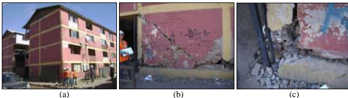
Figura 7. Edificios de albañilería de 4 pisos (a) y daños típicos por esfuerzo de corte (b) y compresión en los extremos del muro (c).
