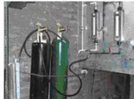
7 Sistema de inyección de gases Botellones y rotámetros para la regulación del flujo de Ar-O 2 -N 2 .
